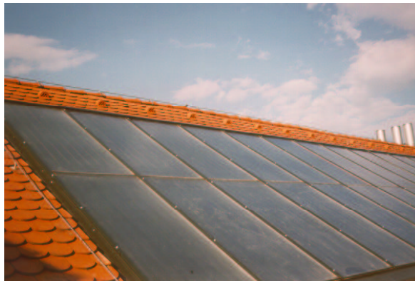
Abbildung 3: Teilsicht des Kollektorfeldes (Quelle: ZREU)
